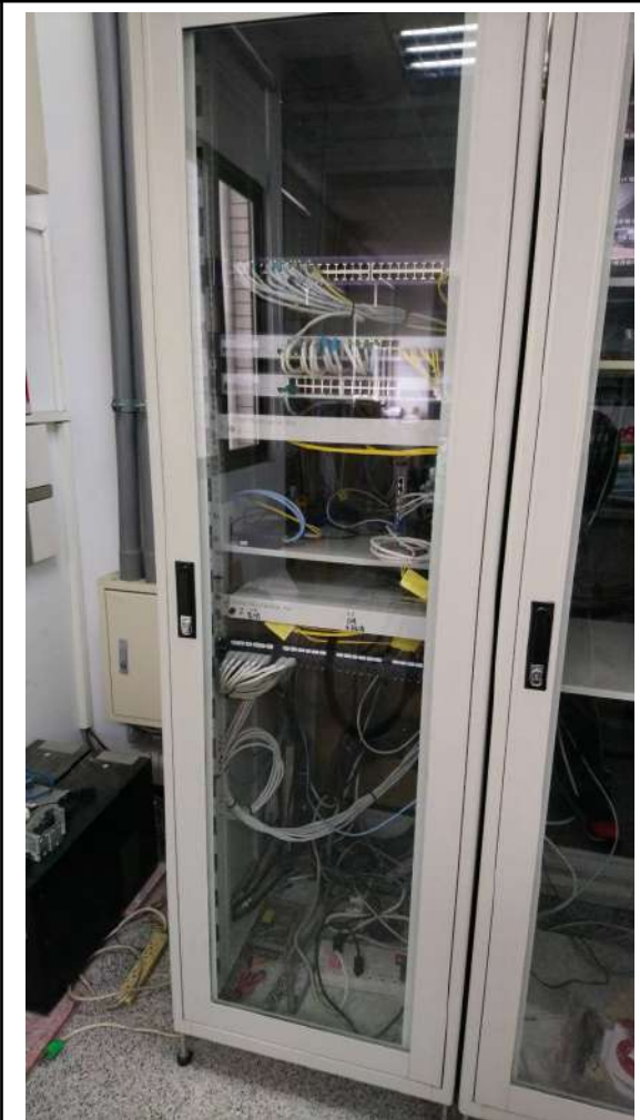
中繼交換點(實習大樓) 網路介接設備支援10G頻寬
