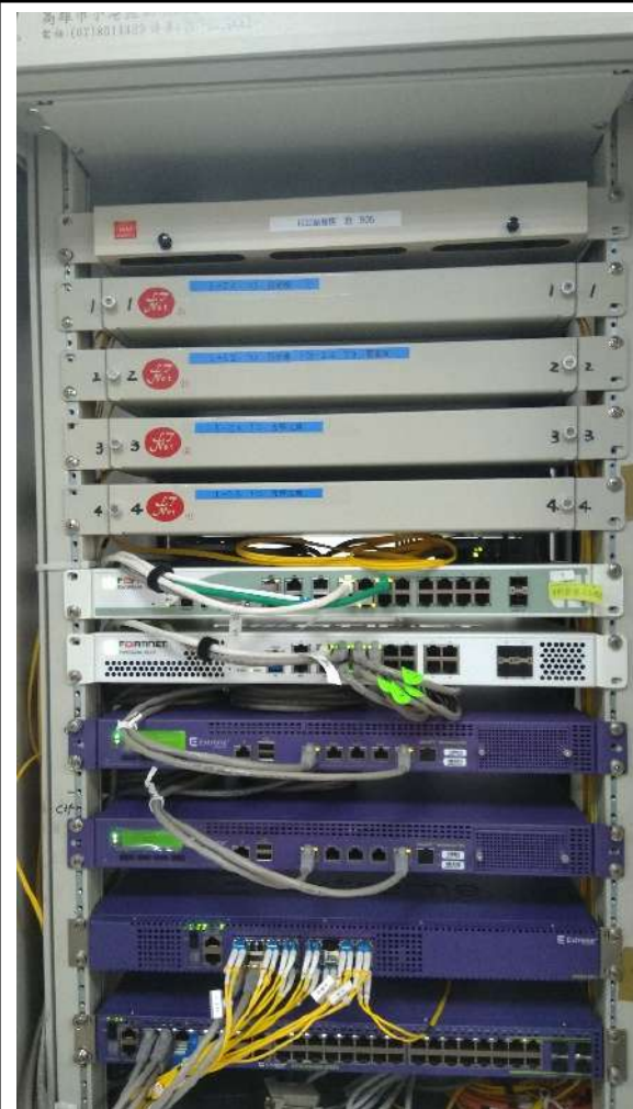
防火牆及核心骨幹交換器(位於行政大樓)
