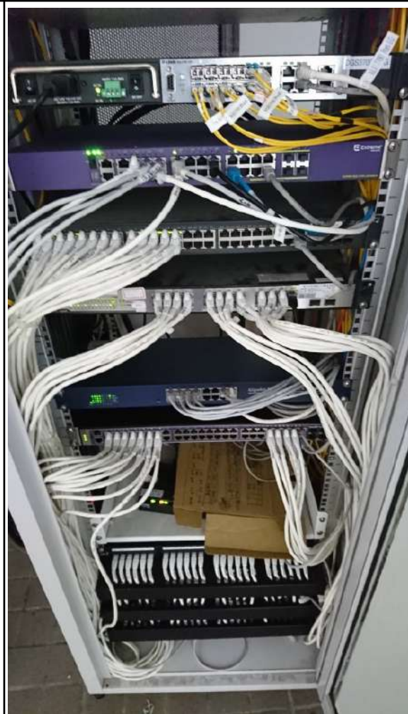
中繼交換點(教學大樓) 網路介接設備已更新支援10G頻寬
