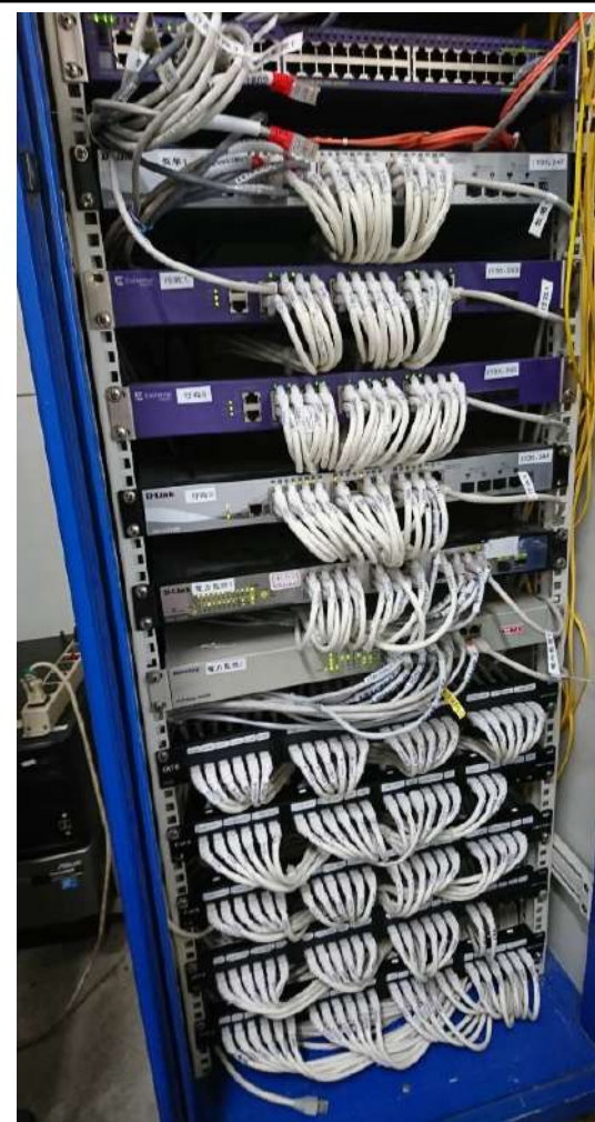
中繼交換點(莒光樓) 網路介接設備支援10G頻寬
